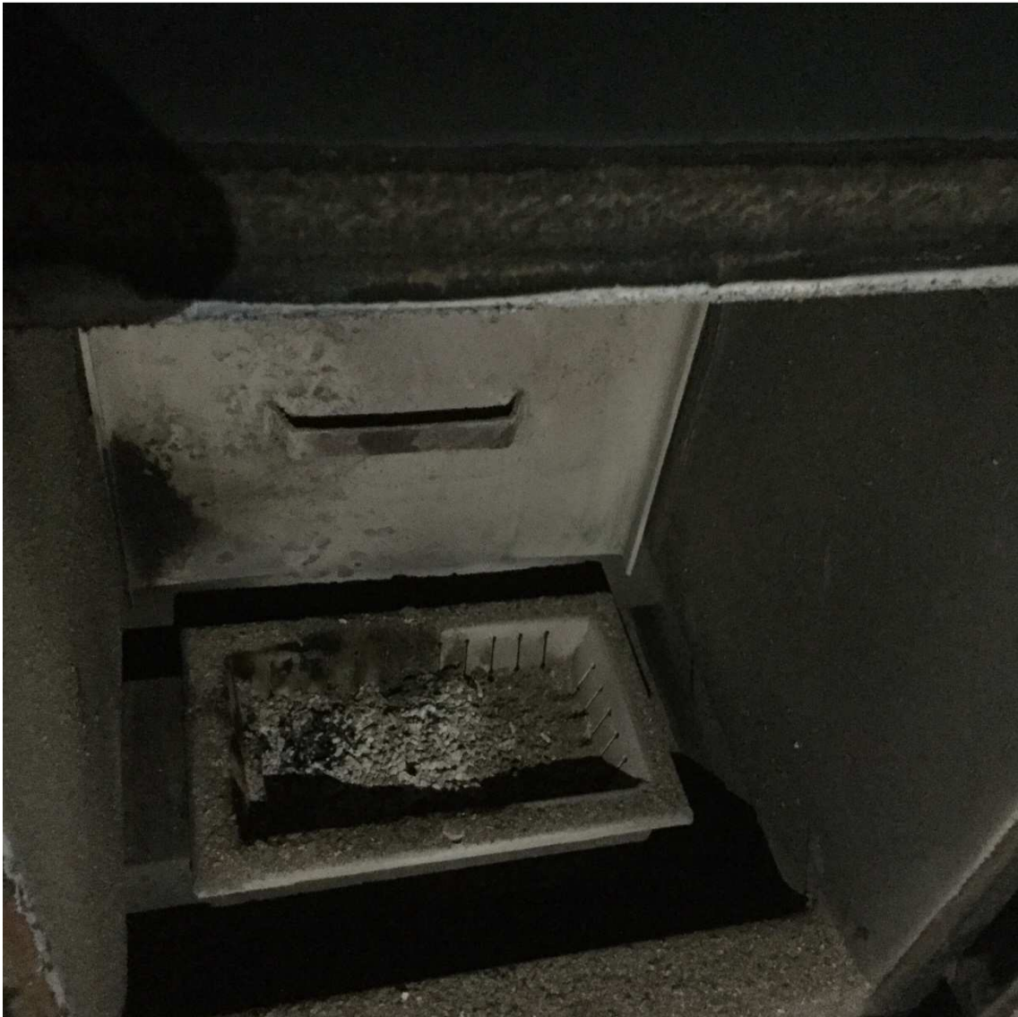
Imagen 2: Quemador caldera nº2 (caldera apagada)
