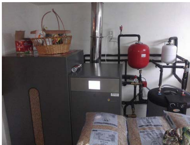
Figura 23.Vaso de expansión instalado.
